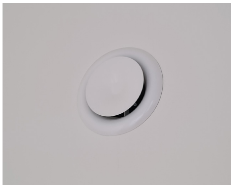
Indblæsningsventil i beboelsesrum
