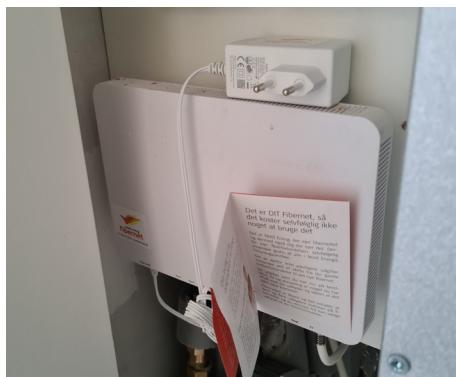
Internetrouter i entréen.
